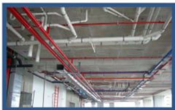
ỨNG DỤNG TRONG PHÒNG CHÁY APPLICATION OF FIRE PROTECTION
